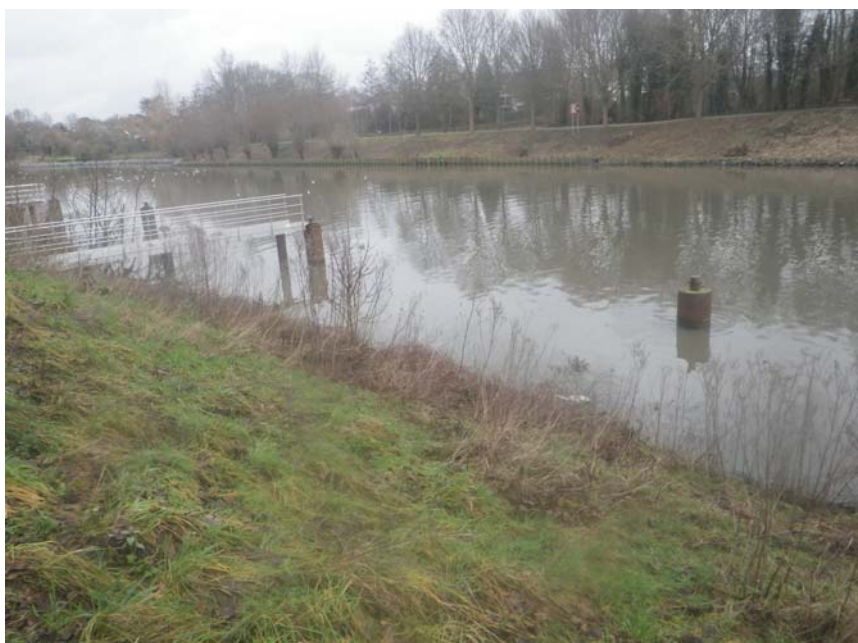
Vue sur le secteur concerné par l'allongement / réfection du poste d'attente aval
